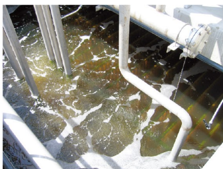
最終処分場 浸出水処理施設
